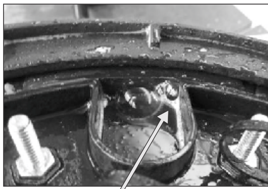
Únik v místě nevyužitého portu kabelového vstupu.
